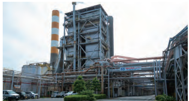
黒液回収ボイラ
