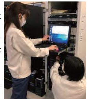
システム点検の様子
