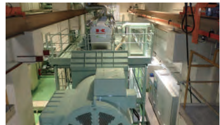
三島工場ガスエンジン発電機
