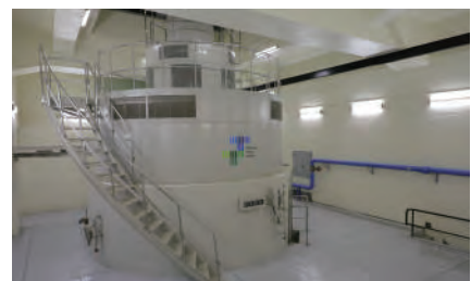
赤松水力発電所
